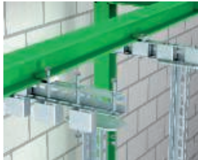
Pendant sur poutre en acier Système de supportage constitué de montants en U crapautés sur une poutre métallique pour le montage de pendants.
