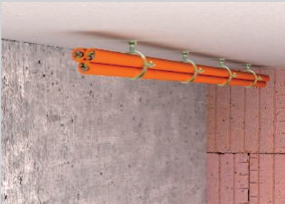
Gebündelte Kabelverlegung unter der Decke.
