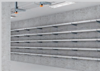
Kabeltunnel mit Bandagen in Kraftwerken.
