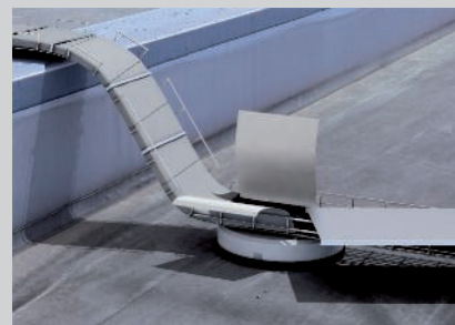
Einsatz bei über Brandwand geführten Photovoltaikleitungen.
