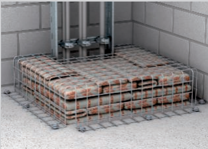
Sicherung gegen Abrutschen oberhalb des Fußbodens.
